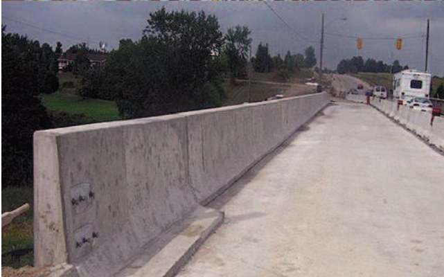
Zbrojenie bariery ochronnej za pomocą prętów GFRP most Irvine Creek, Kanada, [M6]
